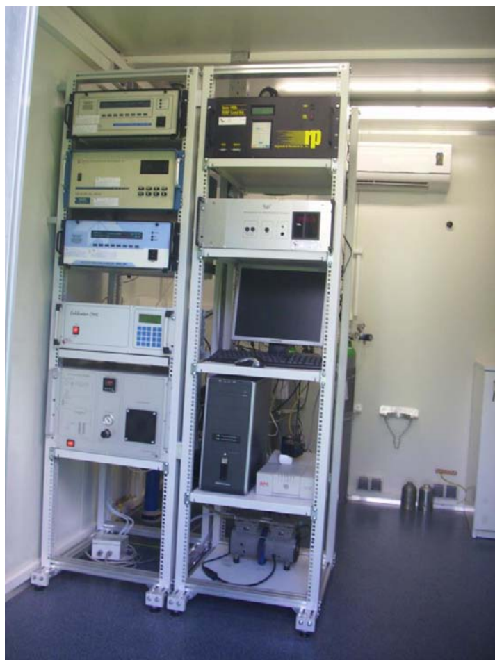
Ryc.2 Nowy kontener na stacji wewnątrz AM1 Gdańsk Śródmieście
